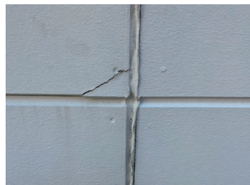
▲シーリング材の“経年劣化”や“剥離”
