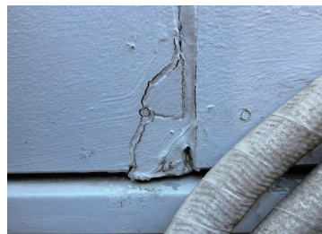
▲外壁の“ひび割れ”や“反り”
