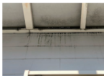
▲“汚れの蓄積”は腐食につながることも
