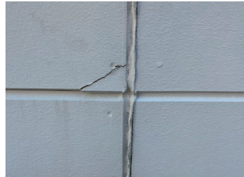
▲シーリング材の“経年劣化”や“剥離”
