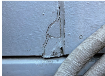
▲外壁の“ひび割れ”や“反り”
